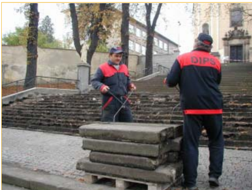
Firma DIPS Zlín zahájila v minulém týdnu opravu schodiště ke kostelu sv. Bartoloměje. Odstranila původní kvádry, které po úpravě podloží přijdou položit zpět.
