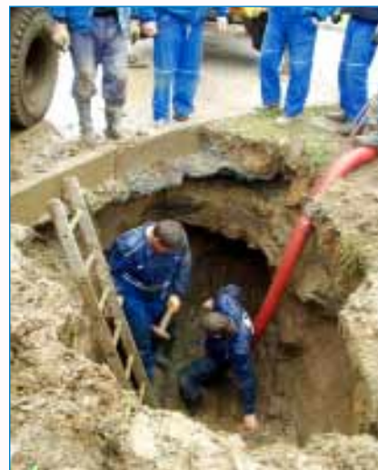
... 12.00 hod - havárie je odstraněna, vše proběhlo hladce.
